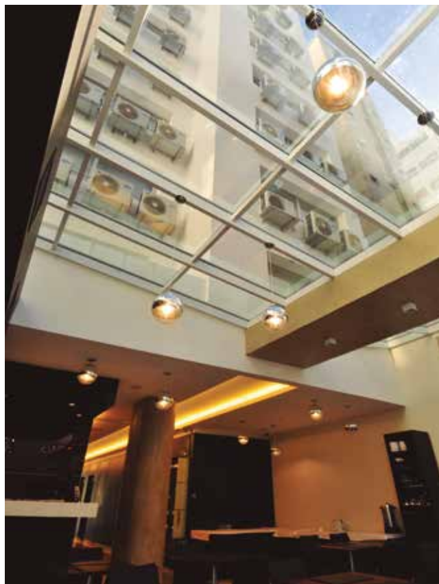
Hotel My Suites Montevideo Renner Construcciones - DVH reflectivos de seguridad.
