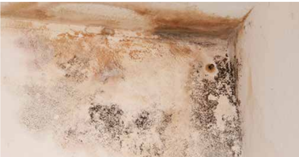
Patologías por humedades
