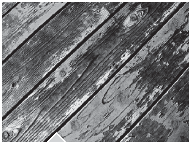
Madera atacada por hongos
